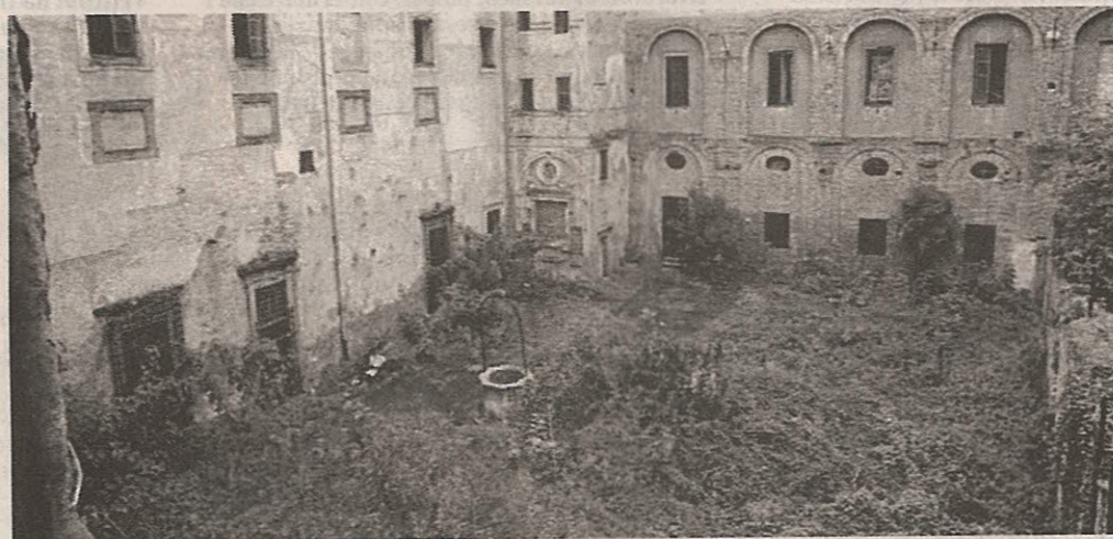
DEGRADO Un'immagine di Palazzo Silvestri Rivaldi, di proprietà Ipad, ma abbandonato da decenni
