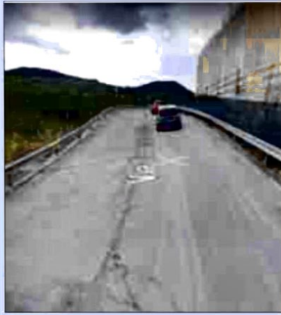
L'immagine tratta da Google maps sullo stato della strada tre mesi fa
